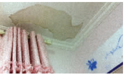
主卧室天花板腻子脱落
