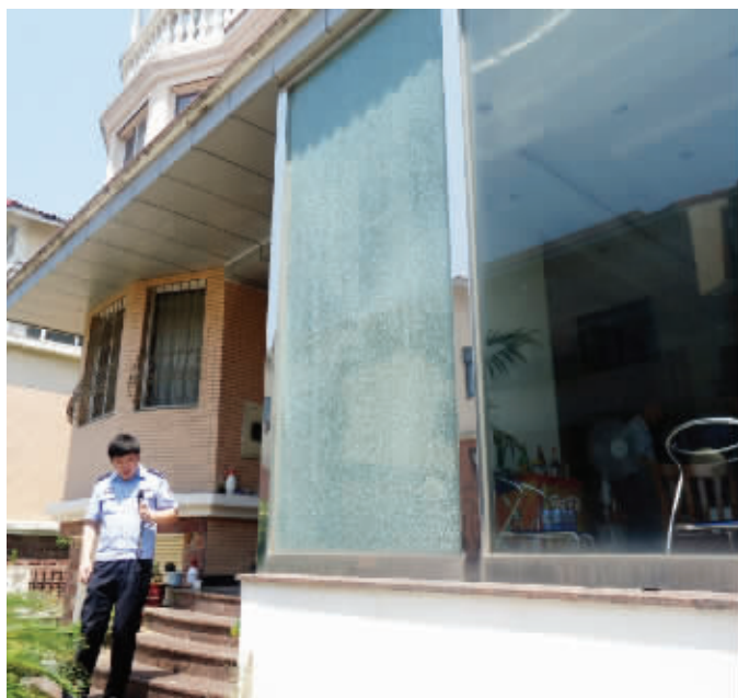
因内外温差而玻璃爆裂的落地窗
