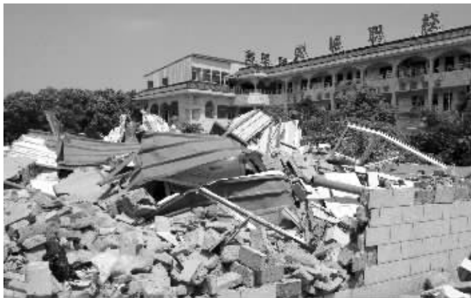
校园部分围墙被拆掉
