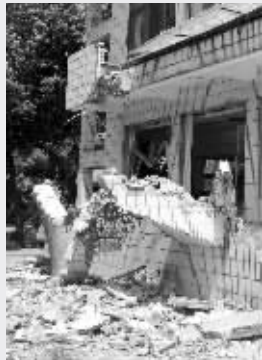
楼梯被扯断,主体部分倒在地上
