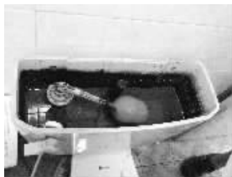
马桶蓄水池内壁都黑了
