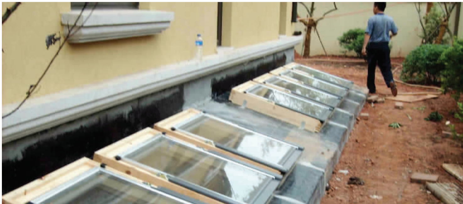
针对地下室渗水,目前开发商一般采取室内水泥浇灌等方式来弥补,但治标不治本 资料图片
