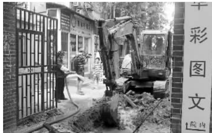
施工人员正在往天然气泄漏的地方浇水 现代快报见习记者 李宇龙 摄
