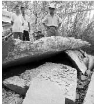
炸开的水泥路现场
