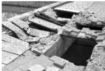
桥面被土方车轧出一个洞
