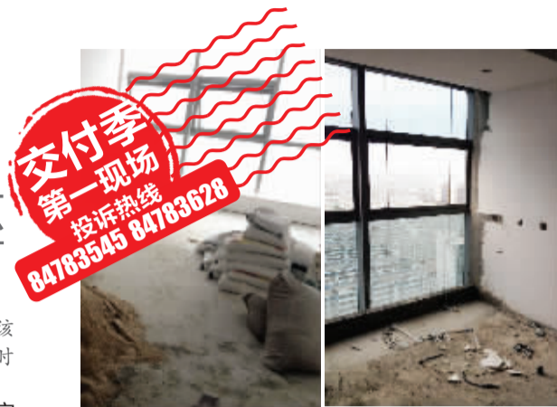
现场多处物料散乱(左图),23楼窗玻璃还没装全(右图)
