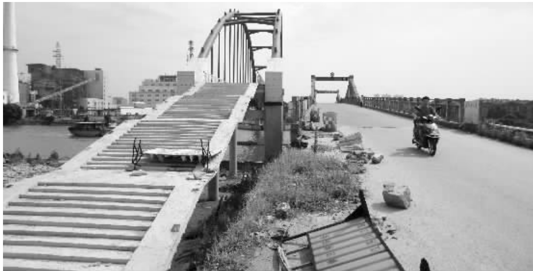
这座“便民桥”的引桥建成台阶式,人们出行很不方便
