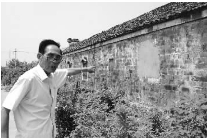
张家老宅西墙的窗户被盗贼破坏后,只好用水泥堵上
