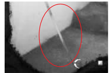
玻璃上的裂缝 网友供图
