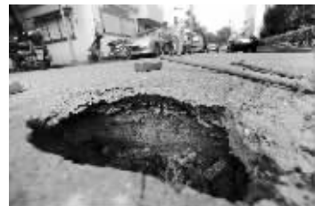
小区里的道路发生塌陷 现代快报记者 施向辉 摄
