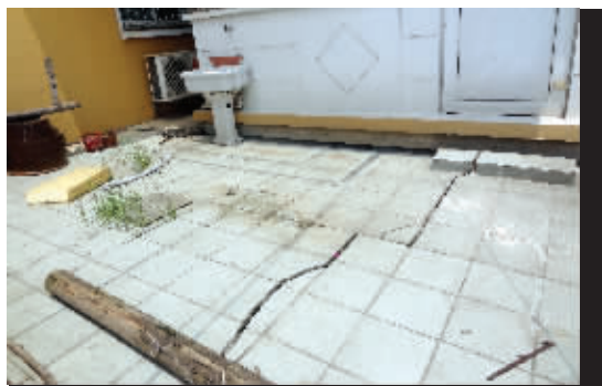
一楼院子地面开裂下沉
