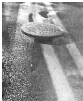
窨井盖跑到了马路上(翻拍)
