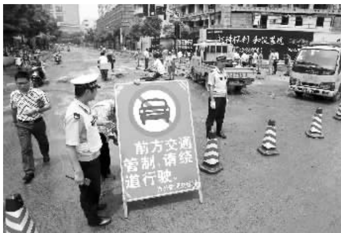
供水管爆裂后,因为抢修附近交通一度受阻 现代快报记者 辛一摄
