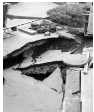
小区路面塌陷 网友供图
