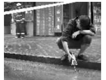
工作人员正在检测漏气点 现代快报记者 辛一 摄
