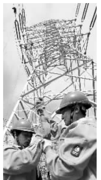
电力职工正加紧进行220千伏伏峰山—淳东送电线路工程施工 通讯员供图
