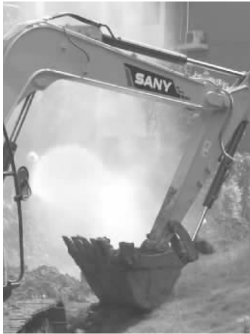
挖掘机挖破燃气管,燃气“刺刺”往外冒 报料人供图
