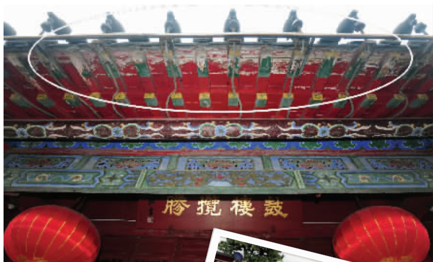
屋檐破损(画圈处)
