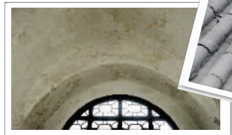
内部的部分墙体发生脱落
