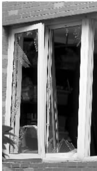
居民家窗户被震碎
