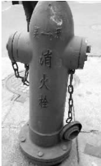
常州街头正在使用的消防栓
