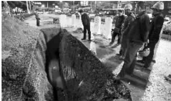
燃气管喷出的气柱一度高达五六米 现代快报记者 顾炜 摄
