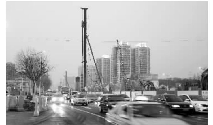
桩机倒地20多分钟后,工地将其吊起复位 现代快报记者 李雨泽 摄
