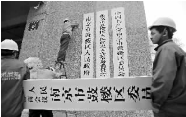
工人们正给新鼓楼区政府安装门牌 现代快报记者 施向辉 摄
