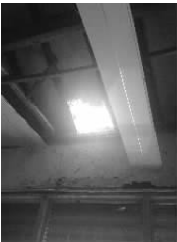
屋顶被凿出一个大洞
