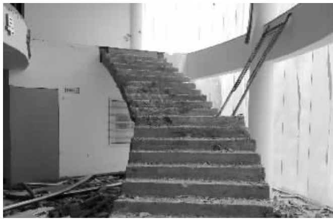
小区活动中心的楼梯已被敲得露出钢筋 刘国庆 摄
