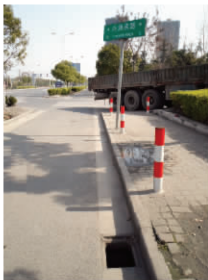
兴源南路多个窨井盖“集体失踪”网友供图
