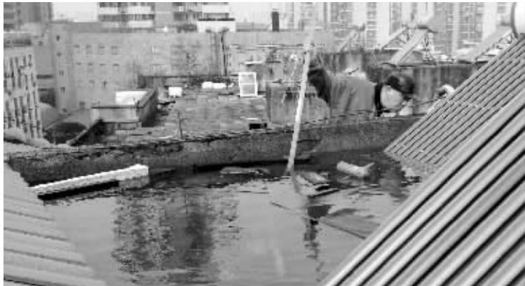
楼梯间平台顶部积水严重,房管所人员在疏通 现代快报记者 孙玉春 摄
