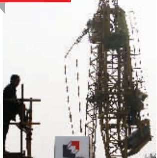
塔吊的吊臂已经折断 现代快报记者 辛一 摄
