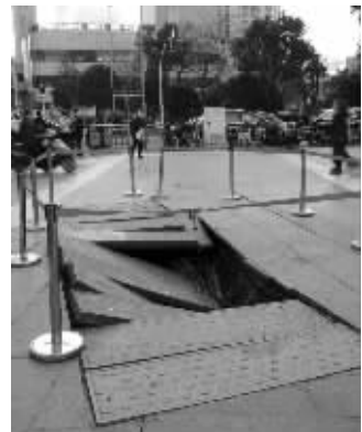
电缆井盖板塌陷,露出一个坑 王小姐供图
