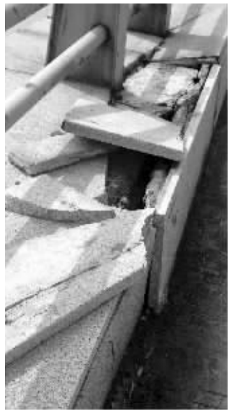
破损的地道护栏面板
