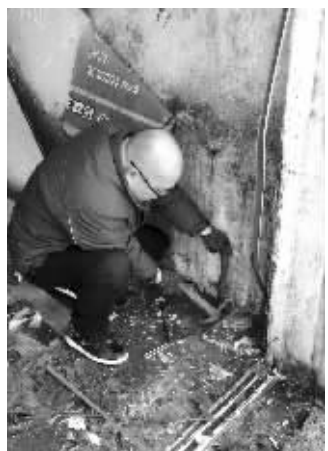
破损的自来水管被堵住
