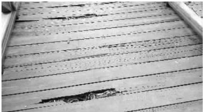
木桥有多块木板破损
