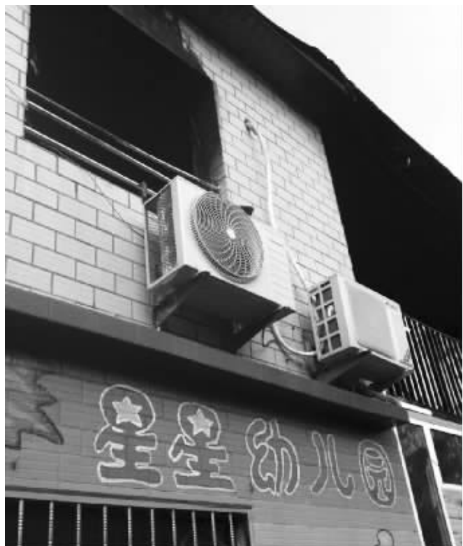
幼儿园楼上的窗户已经被烧黑
