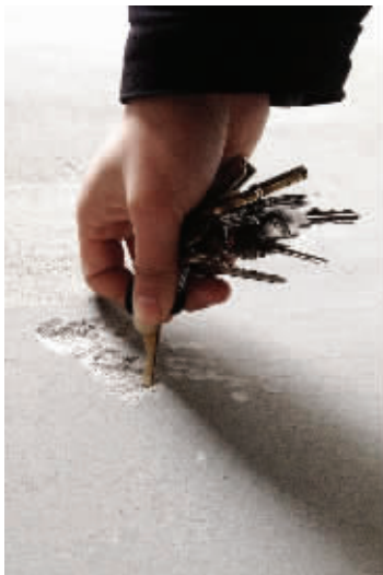
用钥匙划几下,墙面就会出现凹坑
