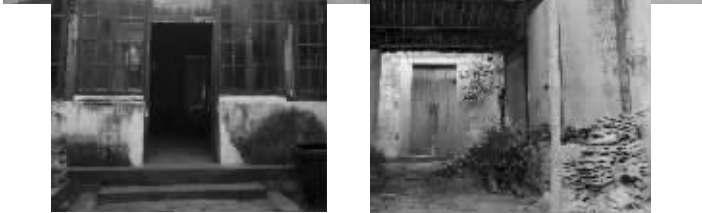
承志堂的门厅破乱不堪,屋顶的许多瓦片已经掉落,透着光,屋梁竟是由一根直径10cm左右的木棍支撑着 王玲玲 摄
