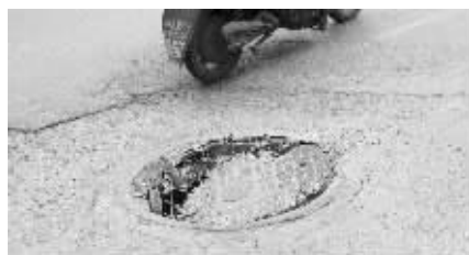
窨井盖破损厉害
