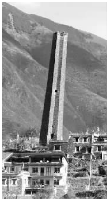
山脚处的碉楼往山体方向倾斜
