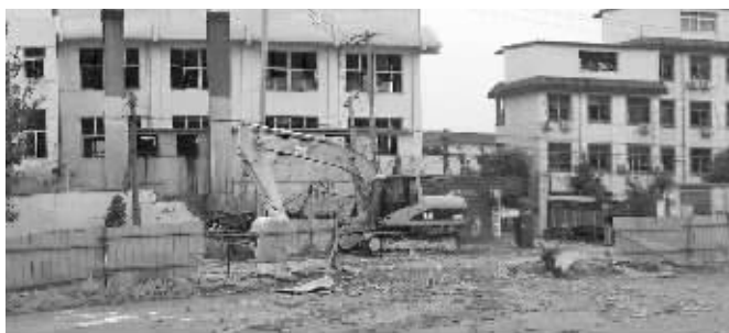
黄山外国语学校锅炉爆炸现场一片狼藉
