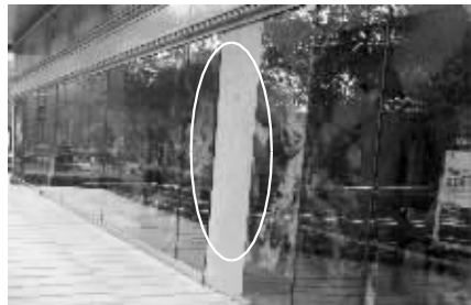
木板挡住了玻璃破碎后的缺口
