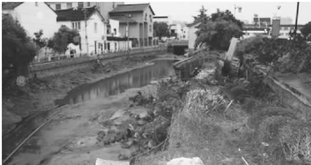
坍塌的驳岸位于一段绿化带之下 图片来自网络
