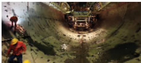
▲纬三路过江隧道N线上月开始掘进 现代快报记者 顾炜 摄
