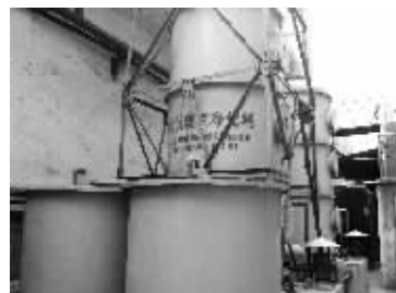
污水处理站内的生化池和废气净化塔
