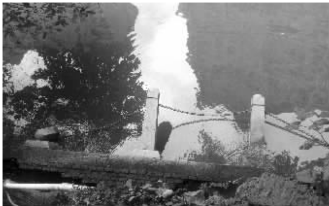
小河驳岸坍塌范围越来越大
