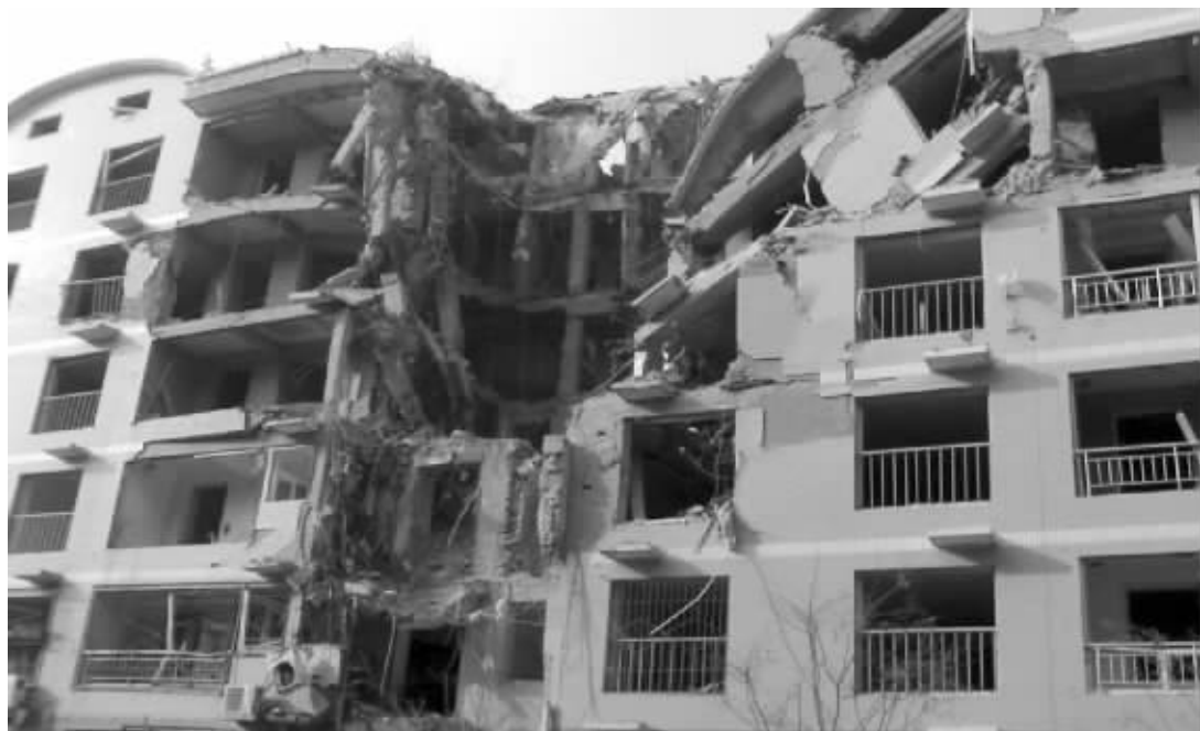
整个居民楼部分楼层已经坍塌
