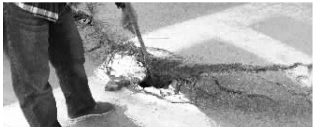
路面上的洞有1米多深
