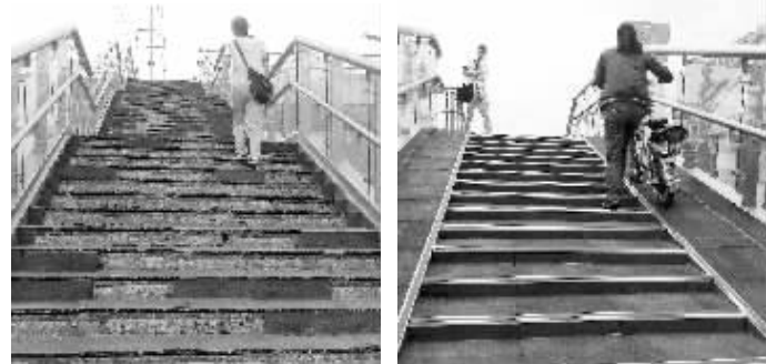
天桥南侧(左图)铝合金压条和塑胶垫损坏严重,北侧完好无损
