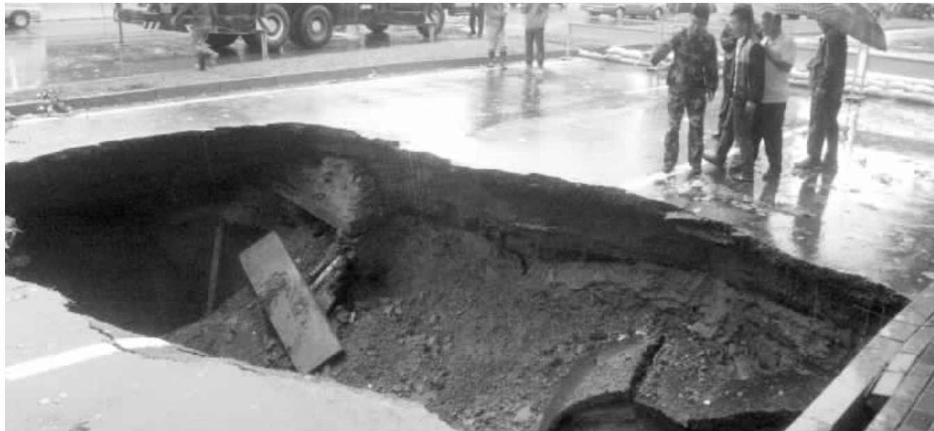
8月29日,哈尔滨街头再次发生塌陷事故 CFP供图
