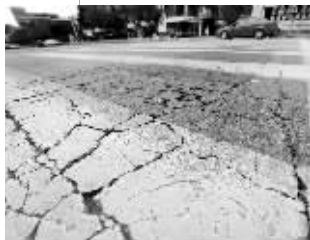
不少路面开裂
