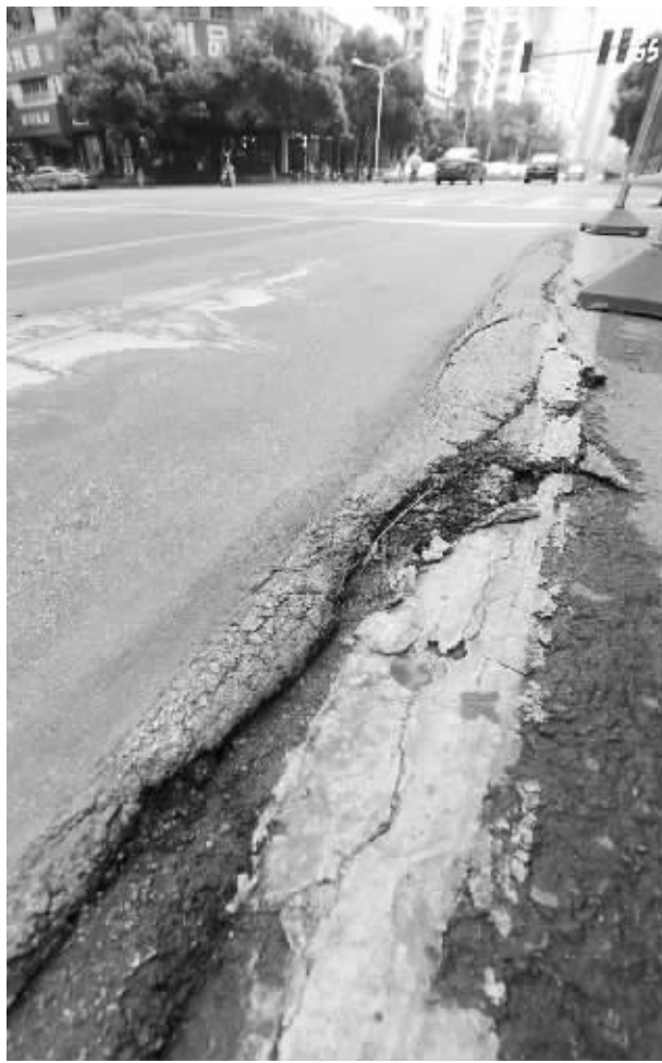
破损实在太厉害,出新刻不容缓 现代快报记者 赵杰 摄
