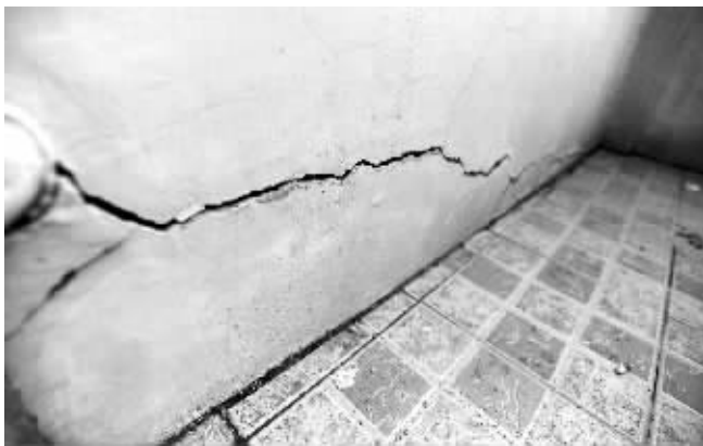
房屋墙壁上出现一条长长的裂缝 现代快报记者 施向辉 摄
